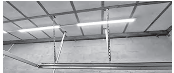
Потолочная система с подготовкой под механизм подъемных ворот
